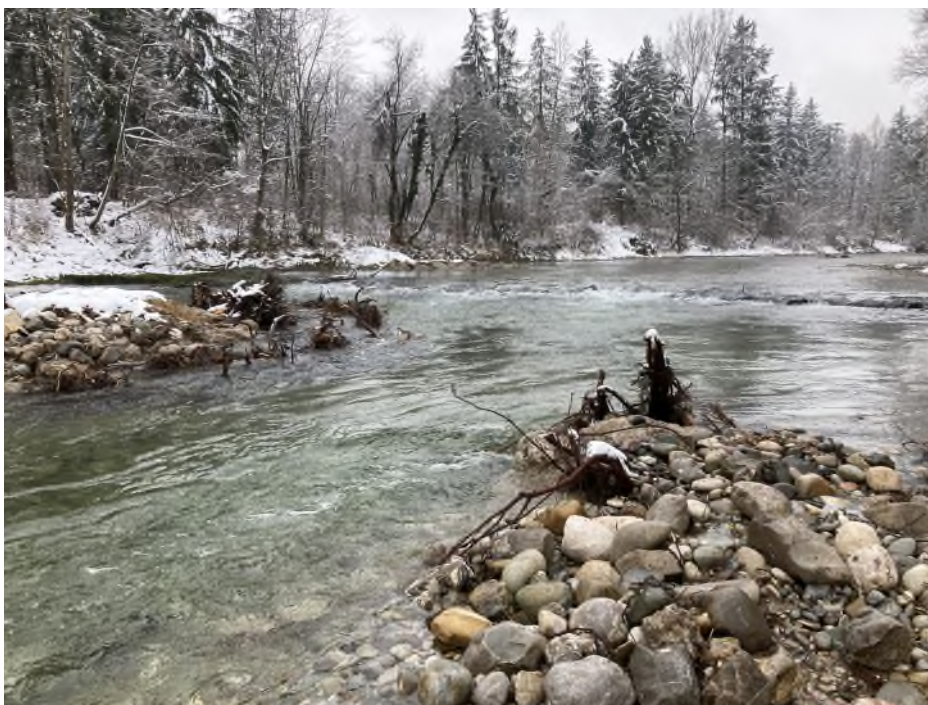
Abbildung 3: Als Teil der Strukturmaßnahmen des Traunsteiner Wasserwirtschaftsamtes und seiner zugehörigen Flussmeisterstelle Salzach ist das Bauwerk nun so angelegt, dass die Fische nach und nach im Wasser aufsteigen und das Hindernis überwinden können. Die zusätzlich angelegten Buhnen lenken zusätzlich die Strömung. Foto: Wasserwirtschaftsamt Traunstein
